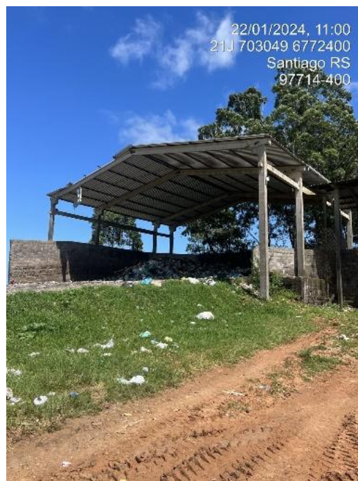
Figura 118: Local de recebimento dos resíduos mistos da ARPES II
